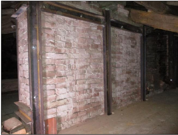
Foto n°4 - Presidio che limita la deformabilità del pannello murario individuato nel sottotetto.
